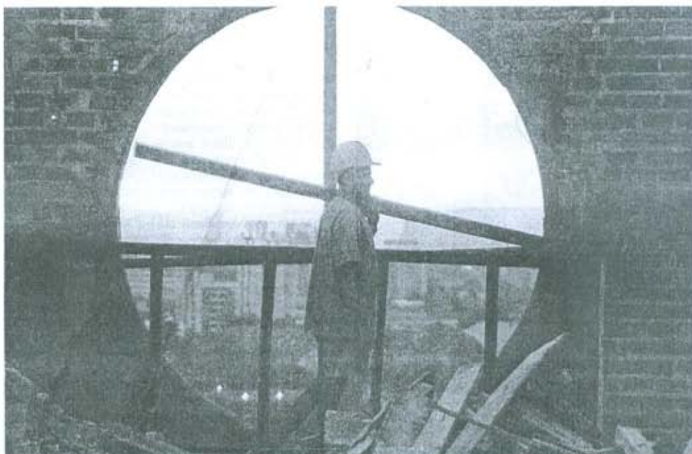
PREFERÊNCIA Os cursos da área de construção civil estão entre os de maior demanda no mercado recifense
