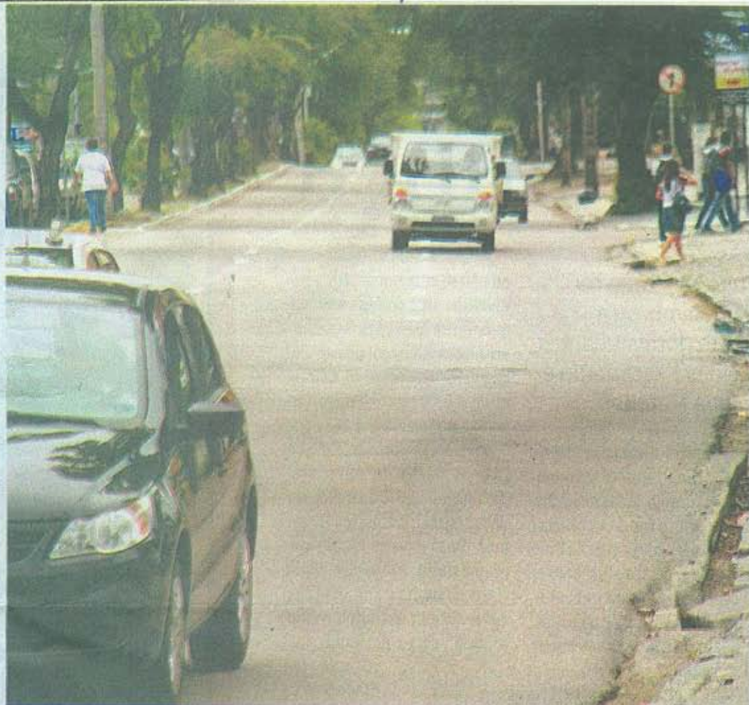
Problema existe em avenidas movimentadas como a Abdias de Carvalho (no alto) e a Domingos Ferreira, em Boa Viagem. Faixas também sumiram no Centro do Recife
